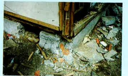
鉄筋が入っていない古い住宅の基礎。土台もくさっている。
