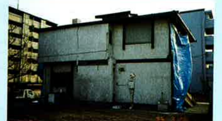
盛土の敷地で基礎工事不良の為キレツの入ったプレハブ住宅。
