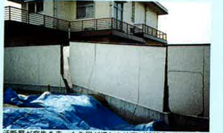
活断層が庭先を走った為崩れた住宅。(淡路島 北淡町)
