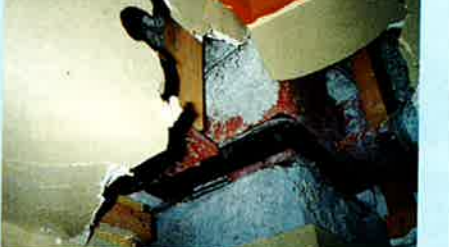
ボックスコラム(箱型鉄骨柱)の1・2階の間の溶接不良工事の例。
