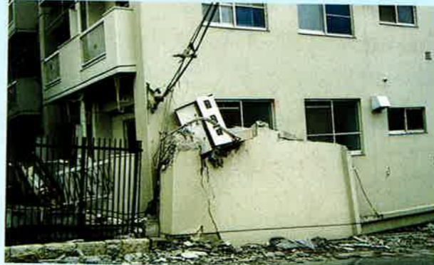
ピロティの壁が少なかった為に1階がつぶれた鉄筋コンクリート造のマンション。
