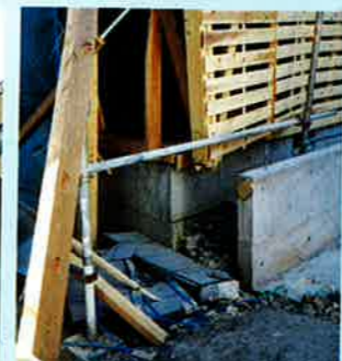
土台と柱の接合不良の為新築中でありながら、壊れた木造住宅。
